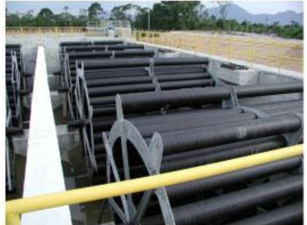
Detalhe da Biocâmara STM® ETE- EMBOGUAÇU - Águas de Paranaguá Paranaguá - Paraná
